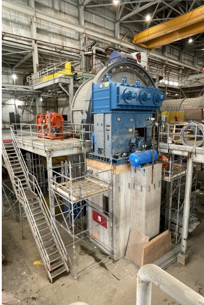
SAG mill motor
